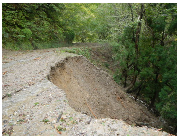
林道崩落（芦生研究林）
