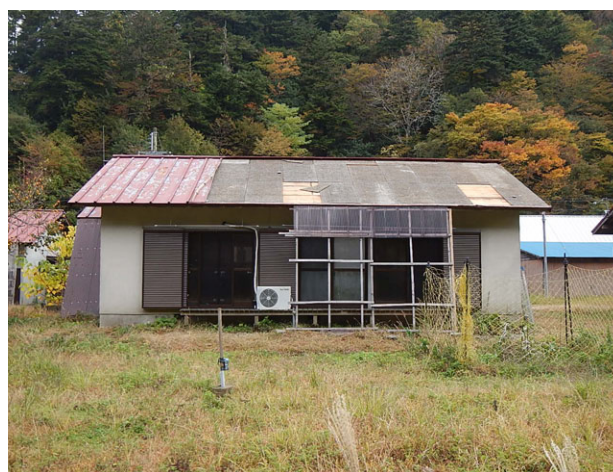
10号棟被害：トタン屋根が剥がれ飛んだ（芦生研究林）
