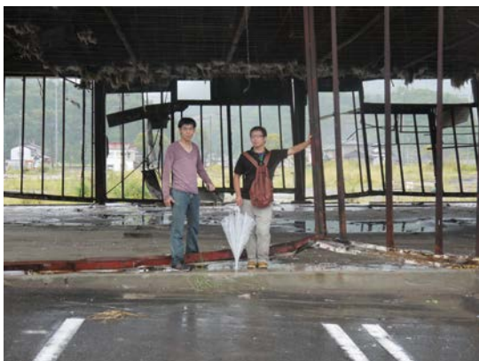
9月25日 12:41 気仙沼市鹿折地区の被災状況を見学
