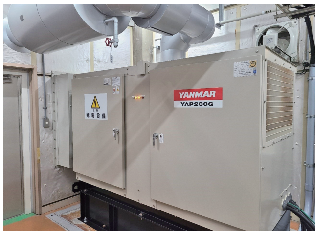
白浜水族館の非常用自家発電設備
